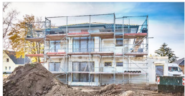
Neubauten sorgfältig trockenlüften
